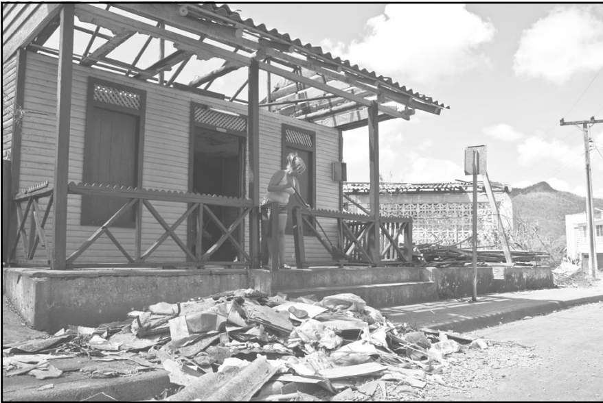
El embate de fenómenos climatológicos se encuentra entre los principales riesgos y vulnerabilidades del país.
