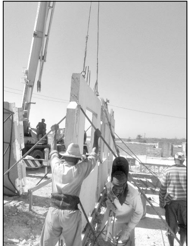
Durante la construcción de la obra, que debe concluir antes de fin de este año, los obreros se sobreponen a las severidades del entorno y del sol pegando duro en las espaldas.
