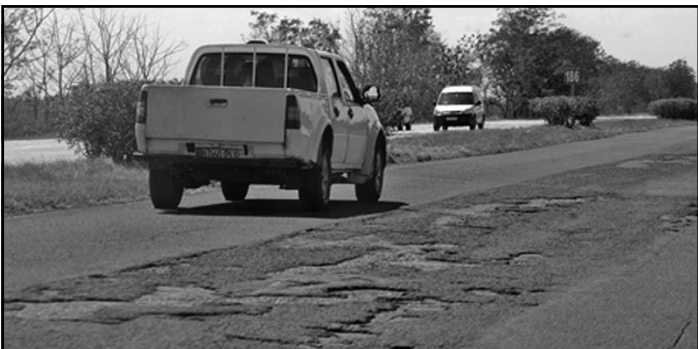
La presencia de tramos en mal estado indica que no siempre las reparaciones han tenido la mejor terminación.
