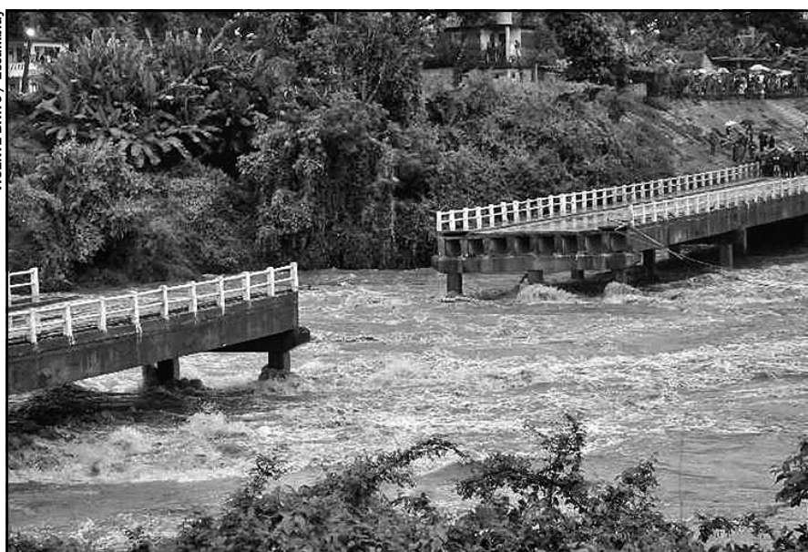
El puente del Zaza fue abatido por la crecida del río, dejando sin comunicación terrestre a Zaza del Medio con Sancti Spiritus.
