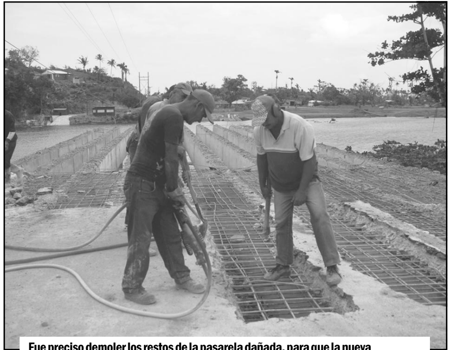
Fue preciso demoler los restos de la pasarela dañada, para que la nueva inversión siguiera su eje vial, como estaba previsto en el proyecto.
