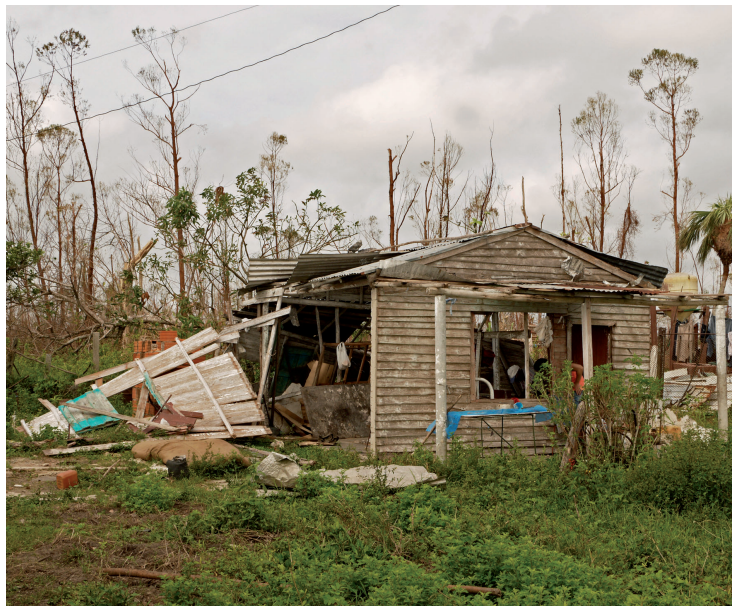
El ciclón Ian dañó principalmente las viviendas con estructuras más frágiles.
