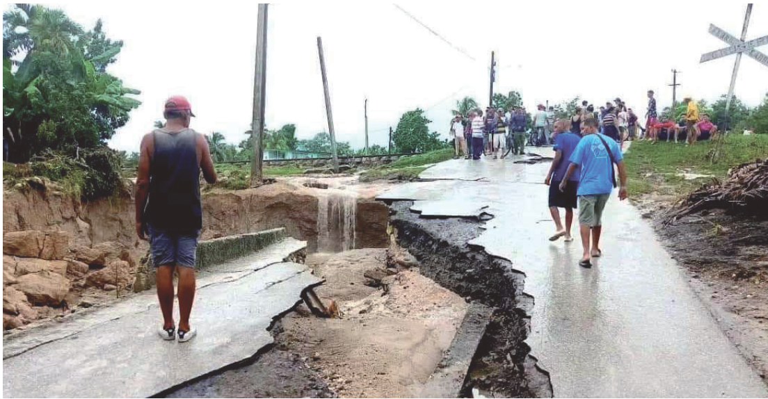
Las inundaciones en el municipio de Jiguaní, en Granma, ocasionaron múltiples afectaciones a la infraestructura. cnctvgranma.cu
