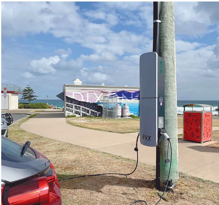
Los cargadores de autos eléctricos, montados en postes, son más rápidos y económicos de implementar que otras unidades de carga en la acera. aus-grid.com.au
